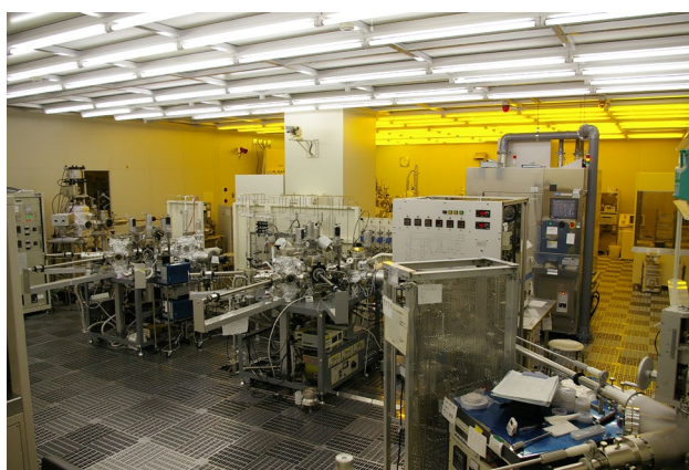
Super clean room in east building. 東棟スーパークリーンルーム
